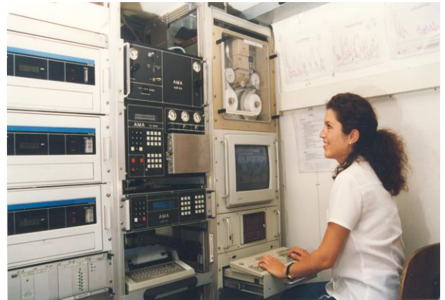
b) Blick auf die Messgeräte im Innern
